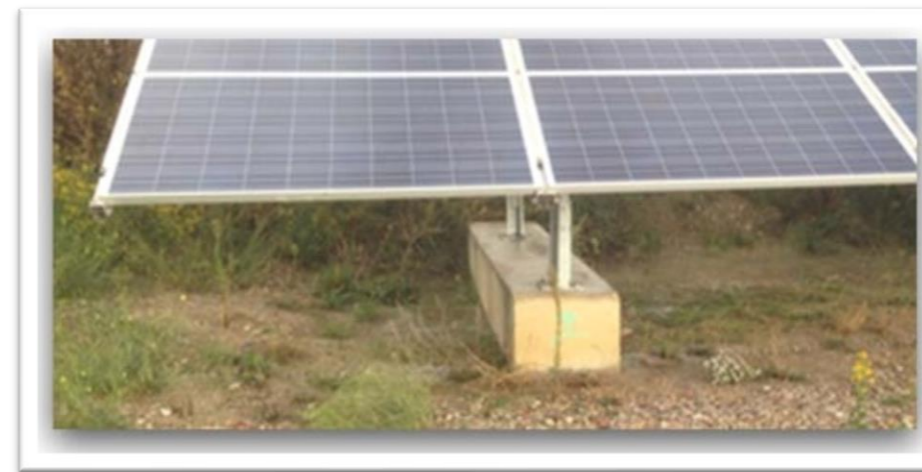
Photographie 1 – Exemple de longrine / Réalisation URBASOLAR (terril de Bramefan, Fuveau)
